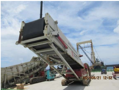
【塩川港でのベルトコンベア設置、作業の加速化が懸念される】
