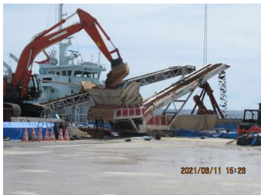
ベルトコンベアで運搬船に積み込む、粉塵対策がなされておらず違反していることが判明。用地使用料にも疑義あり住民監査請求をした。塩川港
